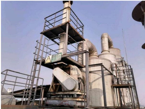
1#车间废气处理装置
