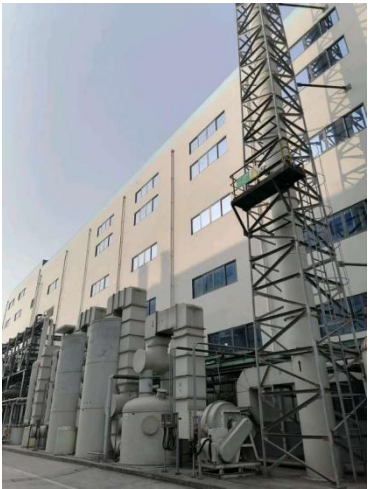
2#车间废气处理装置
