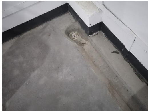
危废间内收集槽
